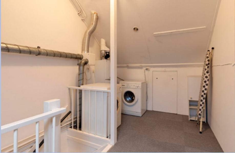
Overloop met opstelling cv-ketel en aansluiting voor de wasmachine en droger. Ruime vierde slaapkamer welke voorzien is van een dakraam.
