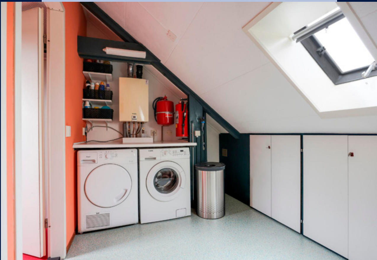
De overloop met bergruimte achter de knieschotten, aansluitingen voor wasmachine en droger en opstelling cv-ketel.
